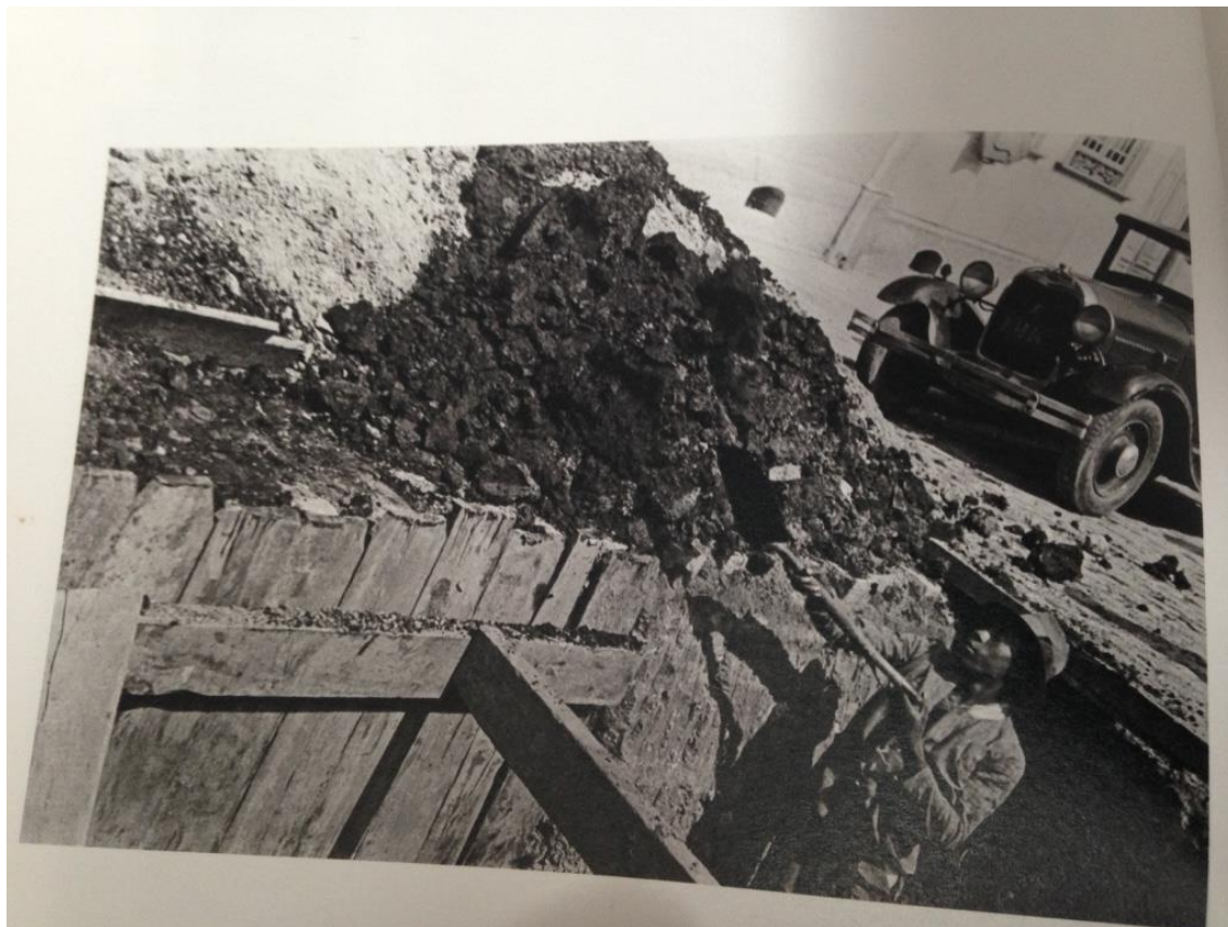
Imagem 4: Instalação de manilhas do sistema de coleta de esgoto, São Paulo, SP, 1940. Fotógrafa: Hildegard Rosenthal.
